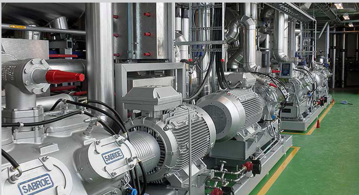
Fig 1: Energy central in Bjerringbro [www.danskjernvarme.dk].
